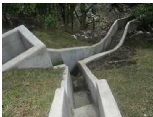
Canalización parcial del Caño La Pajarita. Margen Sur hacia La Iguaná.
